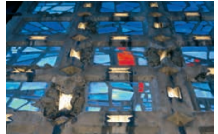
Oben: Abnahme lockerer Betonbrocken der geschädigten Innenseite im Glockenturm, unten: Stark geschädigte Innenseite der Betonwaben im Glockenturm (Fotos © Steffen Obermann/ADB)
