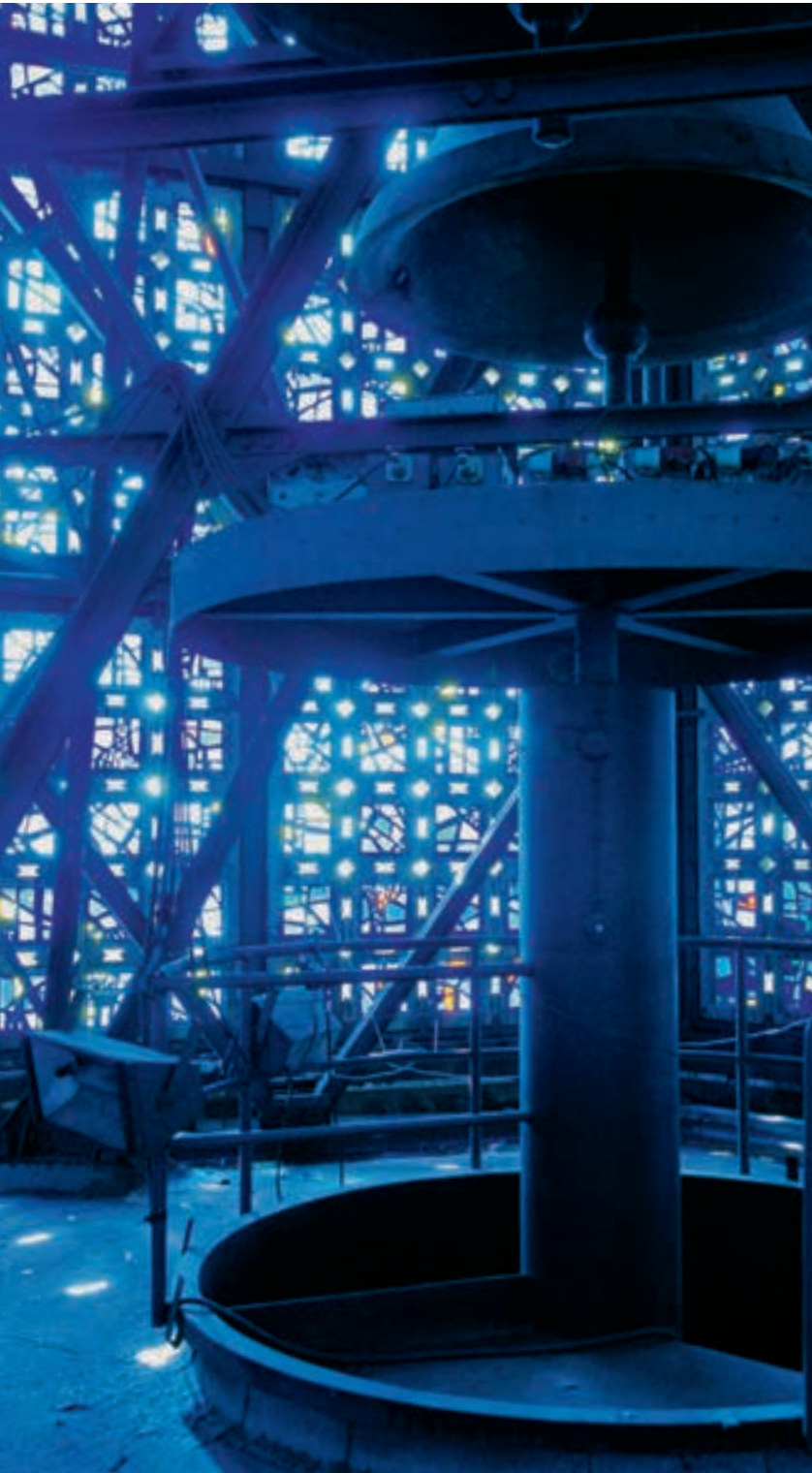
Betonfertigteile mit Schallöffnungen in Stegen und Knotenpunkten in der Glockenstube (Foto © Steffen Obermann/ADB)
